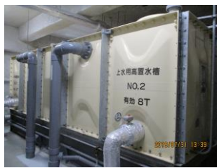
高架水槽 (耐震)
