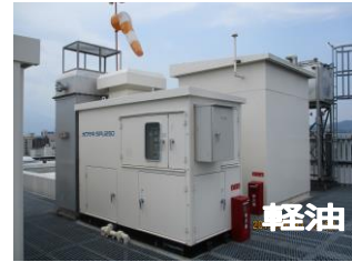
非常用発電機 (4台)
