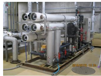
井水濾過装置
