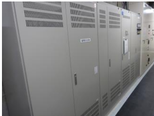
蓄電装置(無停電電源装置)
